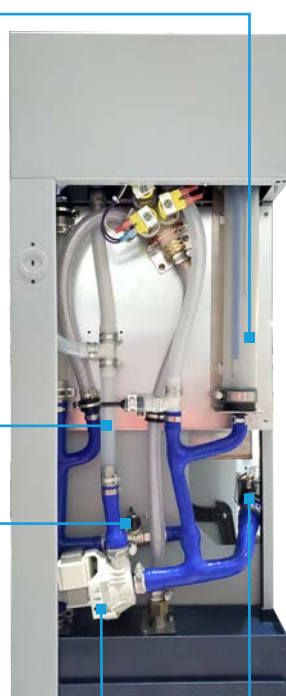
Pompe de drainage motorisée
